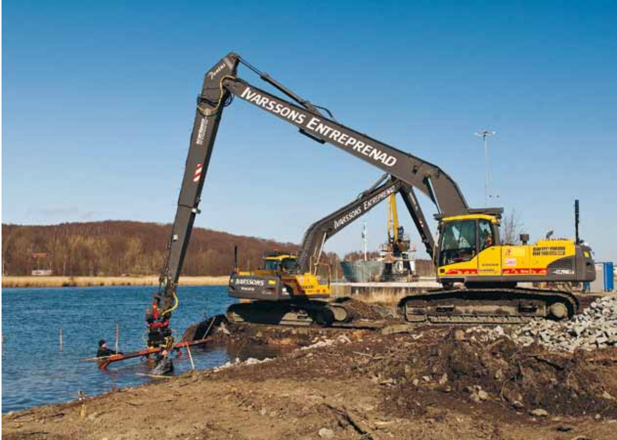
Utefter Göta älv finns mycket föroreningar nedgrävda. Här lägger man ut skydd för att förhindra läckage ut i älven då man sanerar. Foto: Karin Blechningberg
